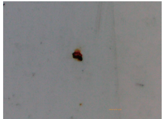
図4 コンテナにできた錆
